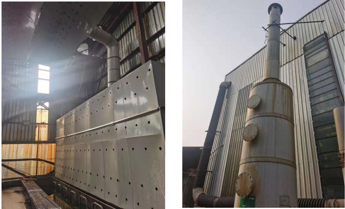
图 1-7 厂区现有阳极氧化硫酸雾收集、处理设施图
