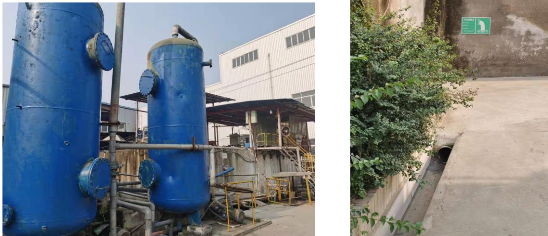
图 1-5 厂区现有生产废水处理站及厂区污水总排放口
